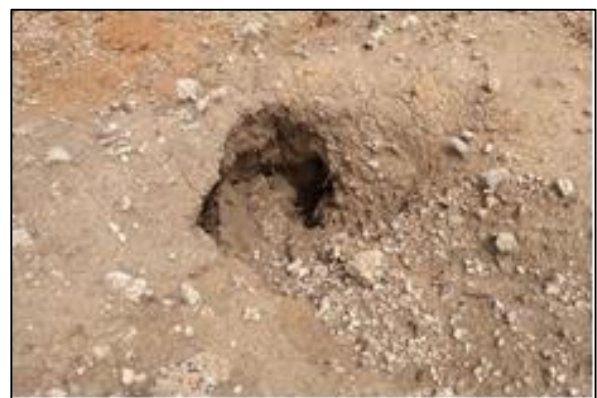
ภาพที่ 1 การเกิดหลุมยุบ (Jugged Hole)
